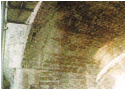
Dissesto della superficie di intradosso del ponte
